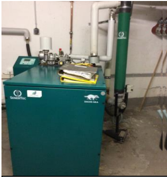
Dachs der Fa. Senertec
