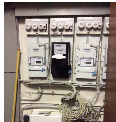
Zählerkasten Übergabestelle NEW/ PPH
